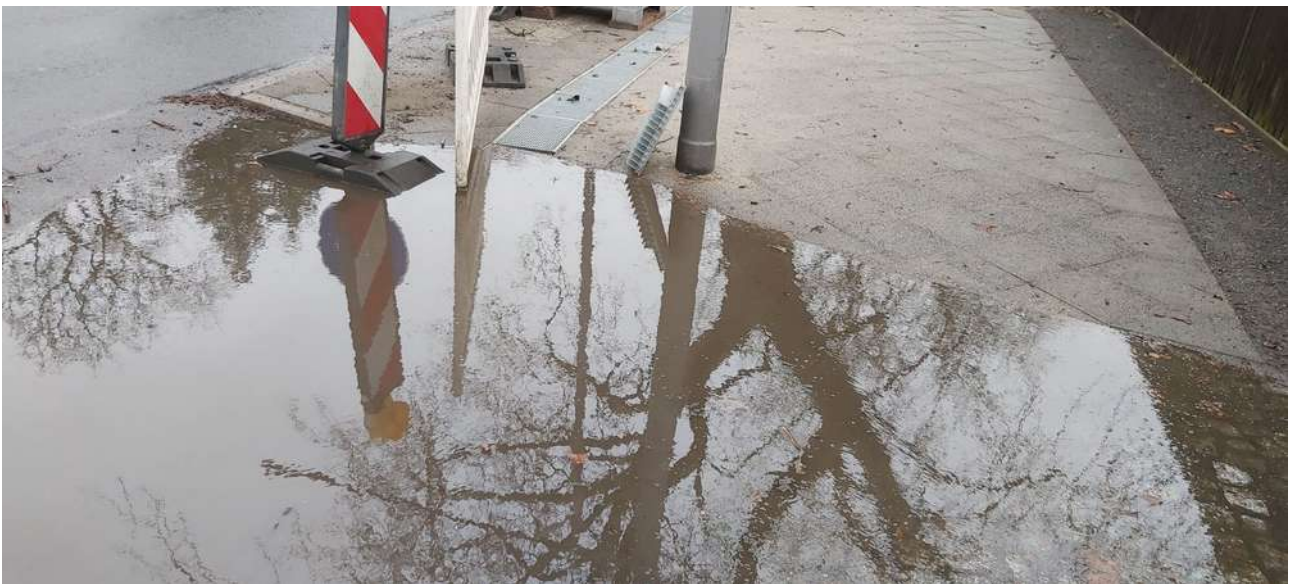
Abbildung 4: Überflutung nach Regen an der Querungshilfe Zabel-Krüger-Damm, /Öschelbronner Weg
